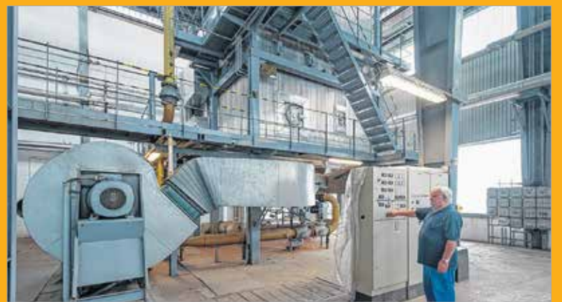
A nagy teljesítményű kazán indításának pillanata
