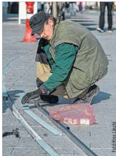
Az indába egy újfajta, vízhatlan ledszalag kerül, kijavítják a kábelezést, és műgyantába ültetik a vezérlőpaneleket
