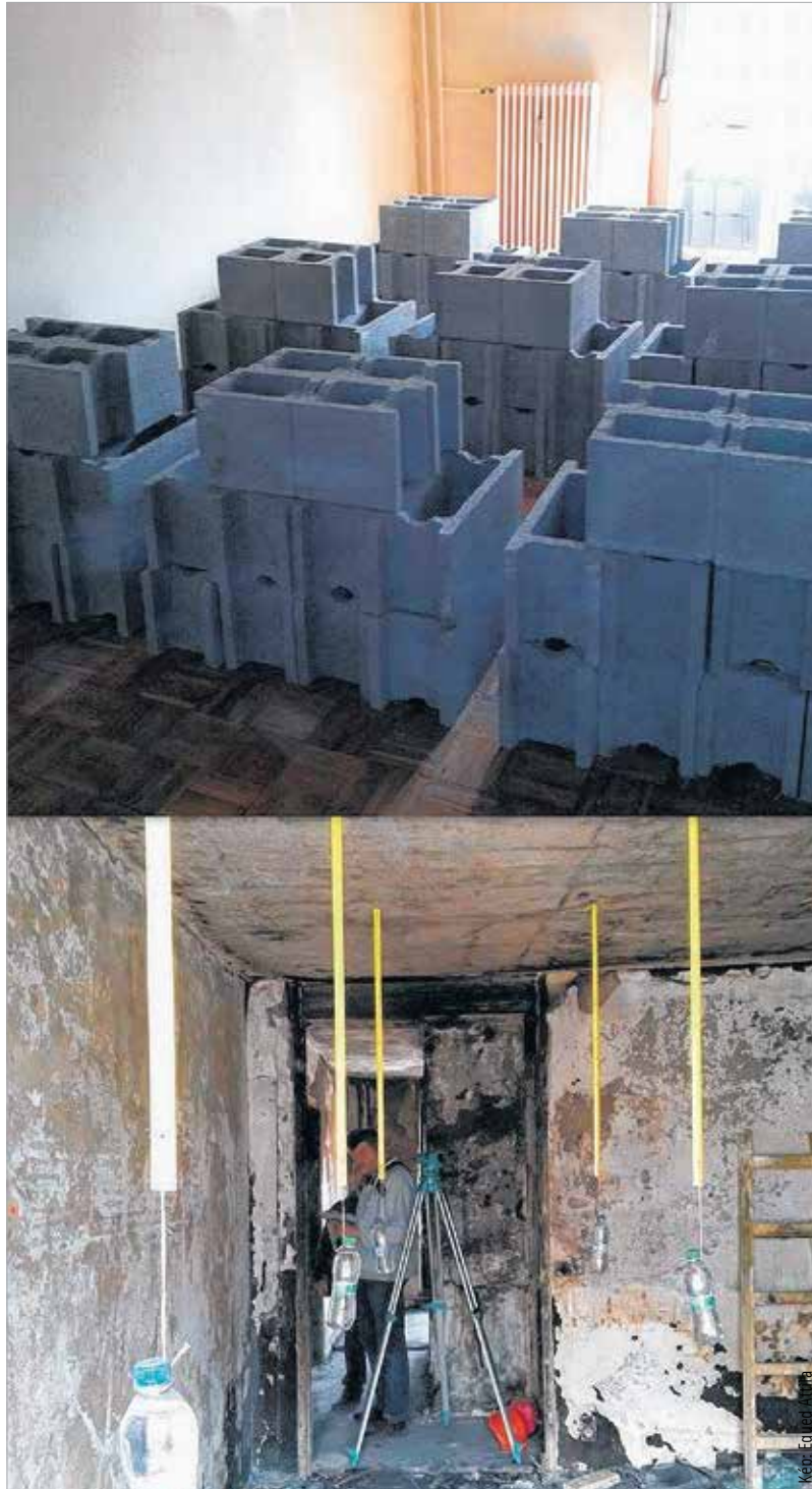
Három tonnányi súlyt raktak a megrogyant födémre, de a panel bírta a terhelést
