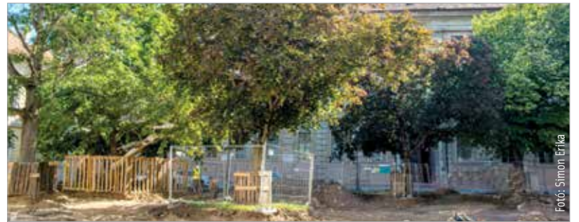
A projekt második üteme zajlik jelenleg, melynek keretében a medence elbontása, a tér és a Jókai utcai érintett szakasz egységes burkolatának valamint a zöldfelületeknek a kialakítása zajlik. Emellett a Csók István Képtár árkádsorának világítását is kiépítik.
