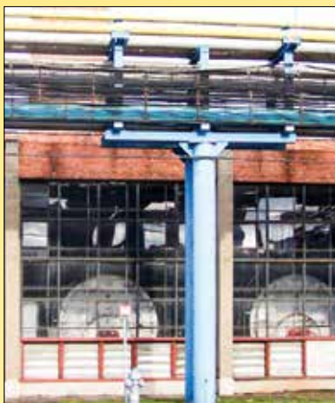
Olajtüzelésű kazánok - Koncz Dezső műszaki igazgató gyűjteményéből
